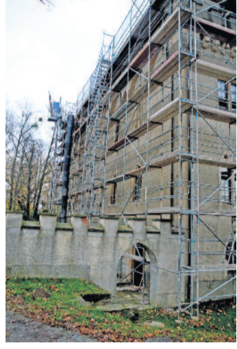
Aktuell werden mehrere Projekte am Schloss realisiert. So zum Beispiel der erste Abschnitt der Dachsanierung.
