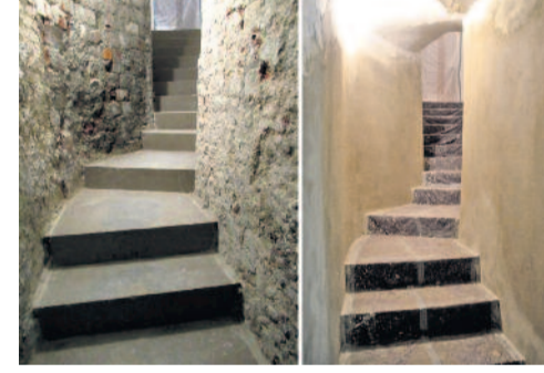
Die Treppe zur Kellertoilette nach dem Arbeitseinsatz Entkernung und aktuell neu verputzt.
